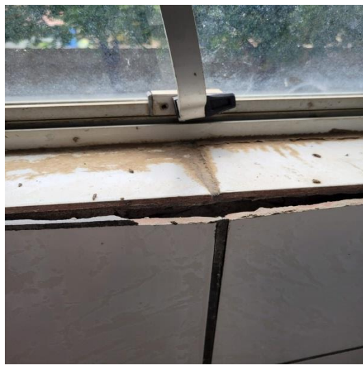
Figura 6: Revestimento cerâmico se desprendendo.
