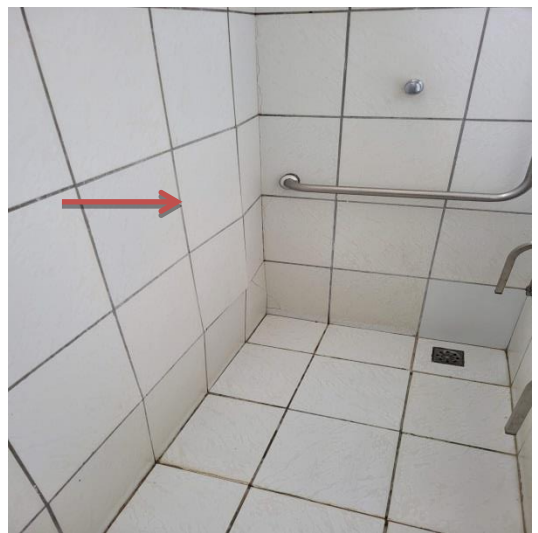
Figura 7: Deslocamento dos revestimentos cerâmicos.
